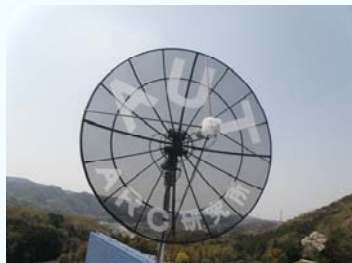
設置されたパラボラアンテナ
